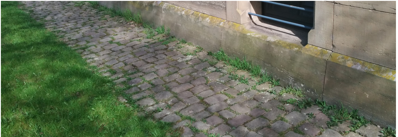
Bewuchs in den Fugen zwischen Pflastersteinen
