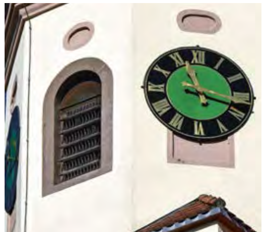
Durch Taubenabwehrmaßnahmen gehen meist auch die Einflugöffnungen für Fledermäuse verloren: Die an dieser Kirche montierten Abwehrspieße gefährden eine Kolonie der Braunen Langohren.
